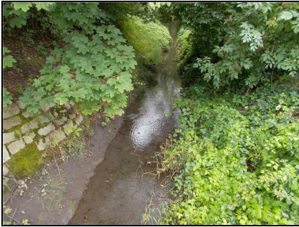
Abb. 2: Verschlammtes Gewässerbett im Maßnahmebereich vor der Maßnahme, 27.07.2017
